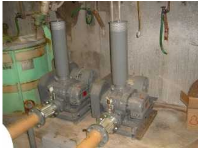
新設ブロワ(2台)
