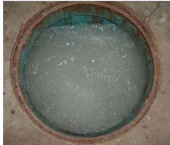
バイオ反応槽(バイオ方式導入8ヶ月後)
